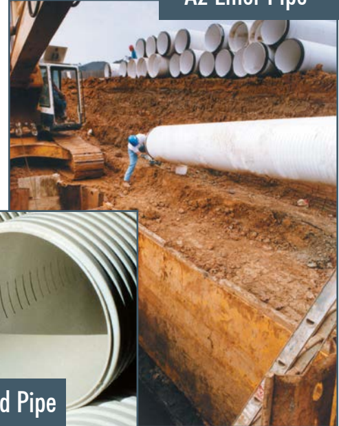
A2 Liner Pipe
